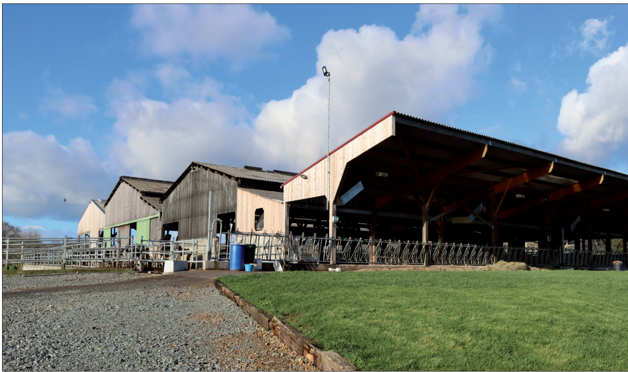
Um die alten Stallgebäude zu erhalten, wurde links und rechts ein Anbau mit Futtertisch durchgeführt.
